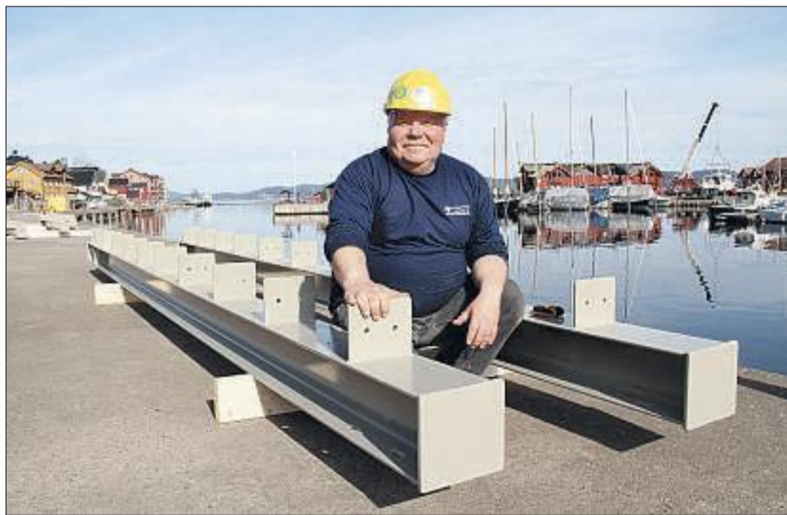
BASEN: Morten Norheim fra Castor Mekaniske verksted i Oslo leder arbeidet med stålbejelkene langs Havnegaten. - Disse bjelkene er spesialtilpasset, så dette skal gå unna, lover han.
