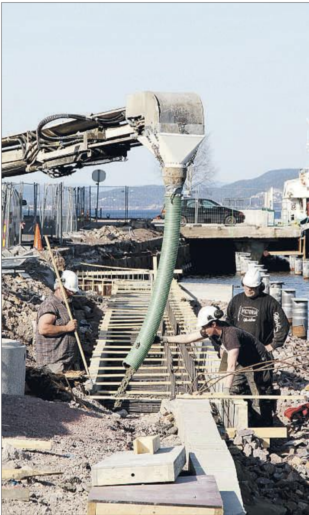
FUNDAMENTERING: 16 kubikkmeter betong fyller forskalingen som karene fra RVS AS fra Hokksund har satt opp. Fra venstre: Arstein Bekken, Øyvind Bekken og Morten Karlsen støper det første av flere fundamenter langs Havnegaten. (Alle foto: Pål Nordby)
