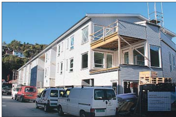
FERDIG DESEMBER 2013: Bekkegaten boligsameie med 27 seniorleiligheter begynner å ta form. (Foto: Pål Nordby)
