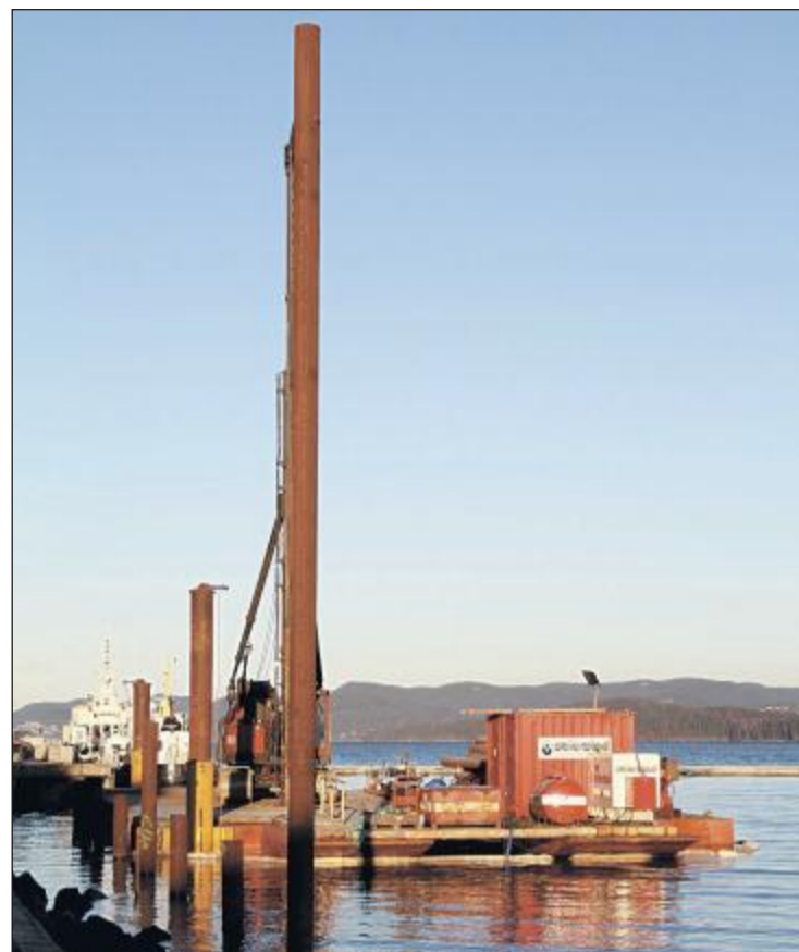
FERDIG: Pælingen langs Havnegaten er ferdig, minus ved amfiet. Nå begynner betong- og stålarbeidene. (Foto: Pål Nordby)
