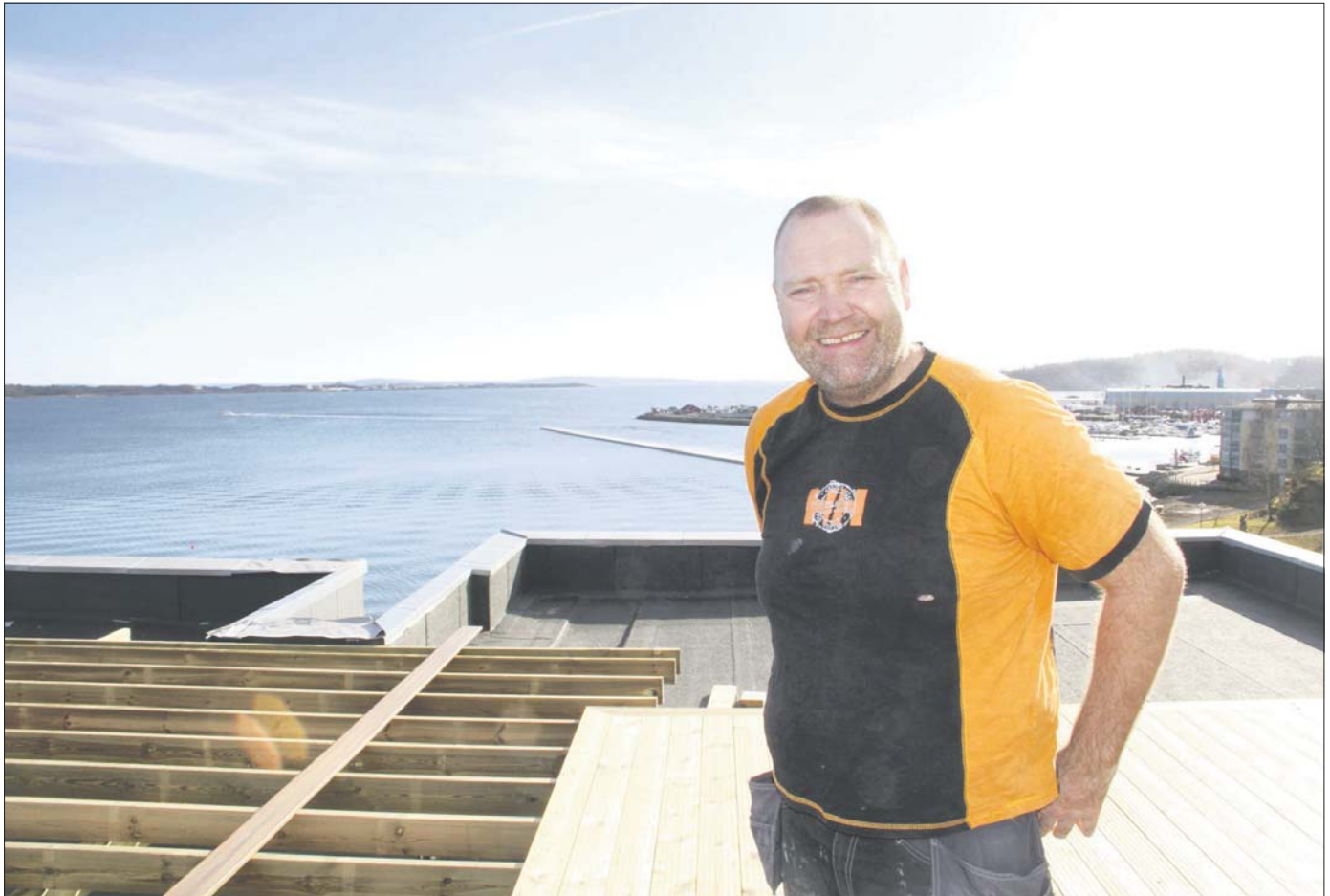
SNART FERDIG: Jarle Pedersen, byggeplassleder, er godt fornøyd med hvordan de nye leilighetene tar seg ut. - Jeg syns de har gitt hele bygget et løft, sier han. Én av tre leiligheter på toppen av hotellet er ferdig, de to andre skal være innflyttingsklare til påske.
