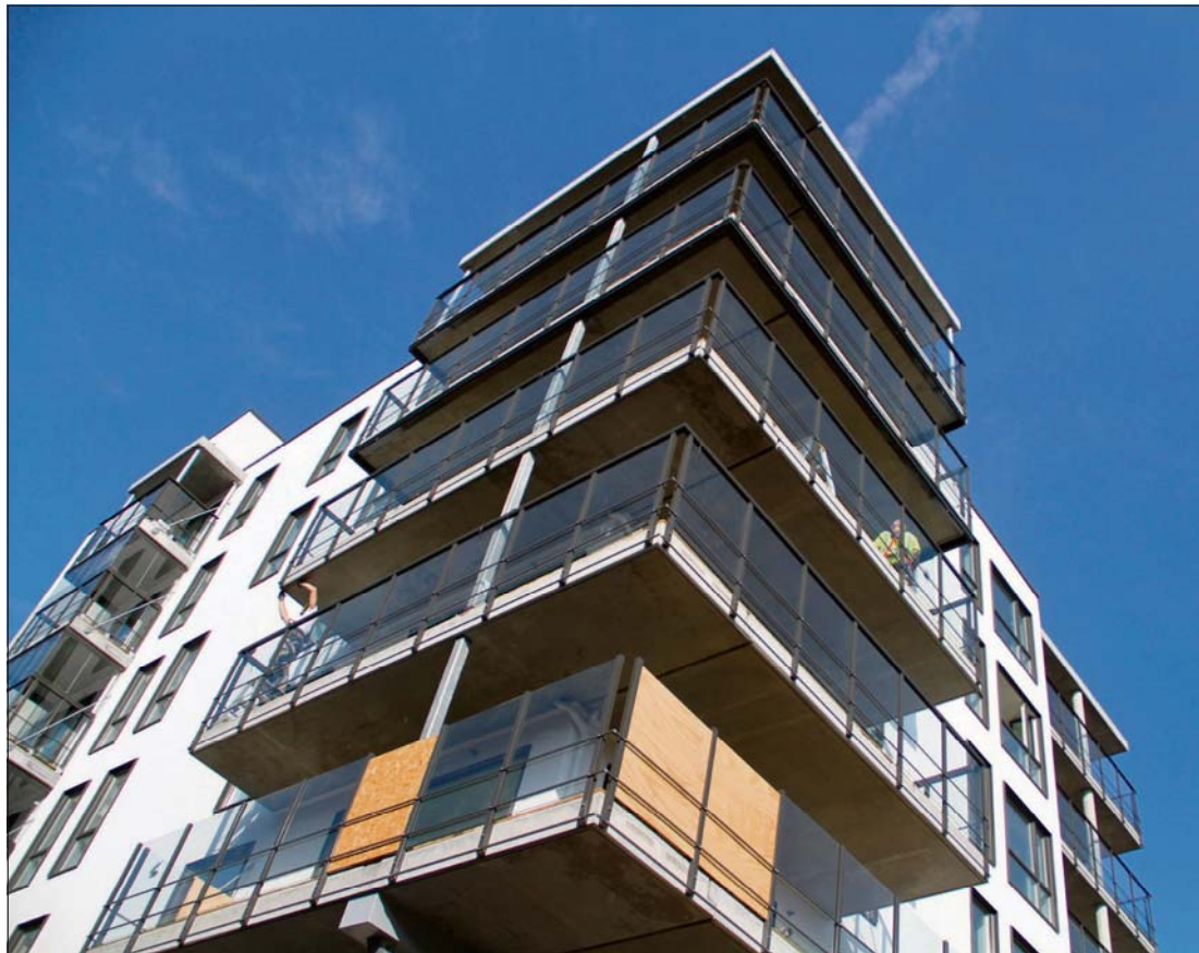
BYGGER: Håndverkere legger siste finish på Holmestrand Utviklings nyeste sentrumsbygg, byggetrinn fire i Bibliotekkvartalet.
